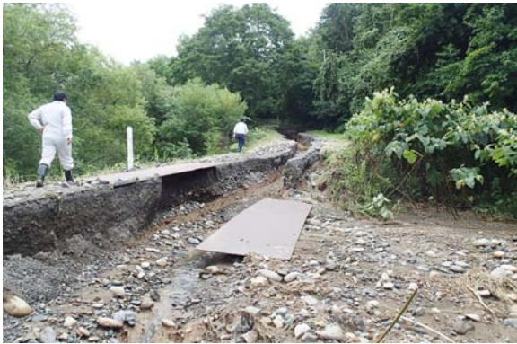
大雨により削られた賀張地区の町道
