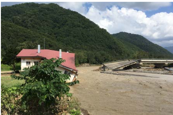
落橋した千呂露橋と倒壊した千栄生活館
