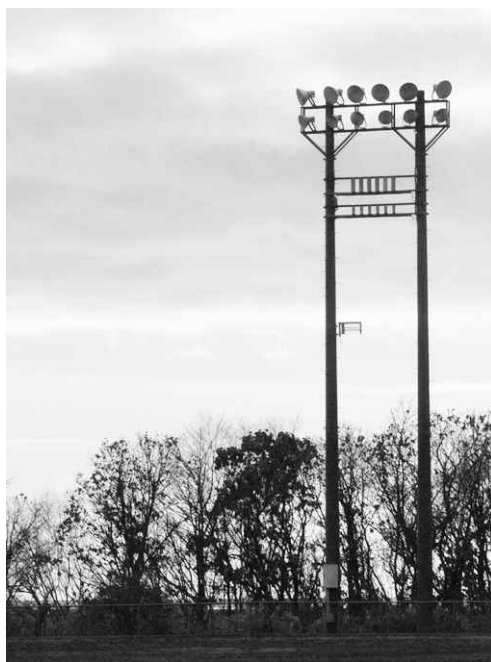
▲照明塔の復旧が望まれる町営富川球場
