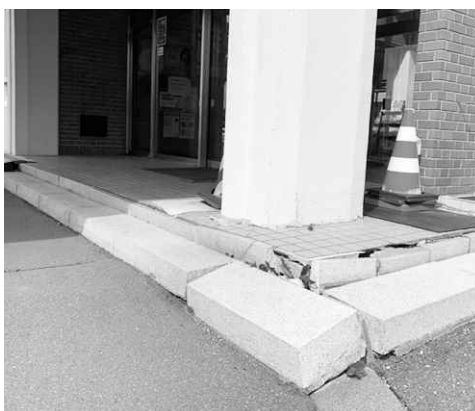
▲ 手すりも無く、一部破損している役場本庁舎正面玄関
